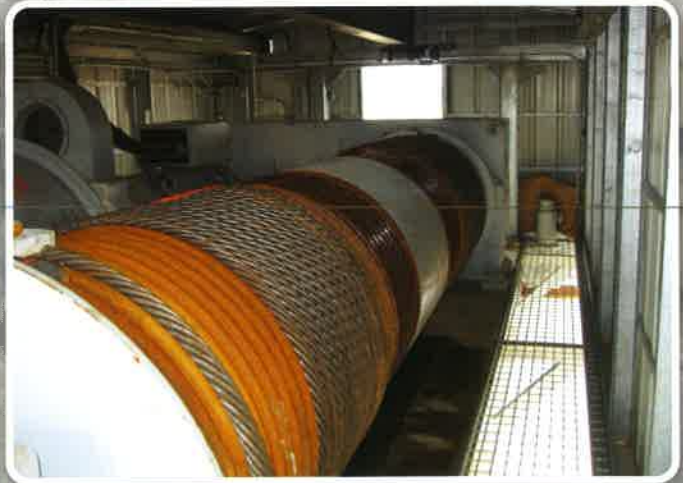
40 TON TROLLEY HOIST
